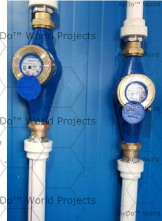
Entrada de agua sucia y Toma de agua Rehabilitada contadores
