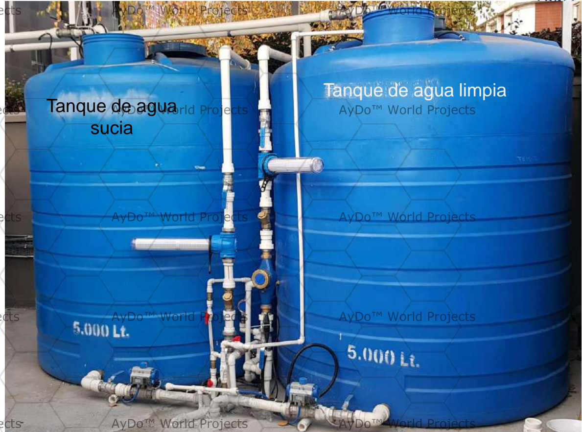
Tanques aéreos de agua sucia y limpia
