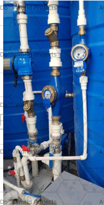
Contadores de agua de lluvia, entrada de red y salida de WC
