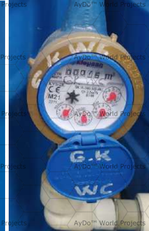
Agua de descarga del WC Contador de salida
